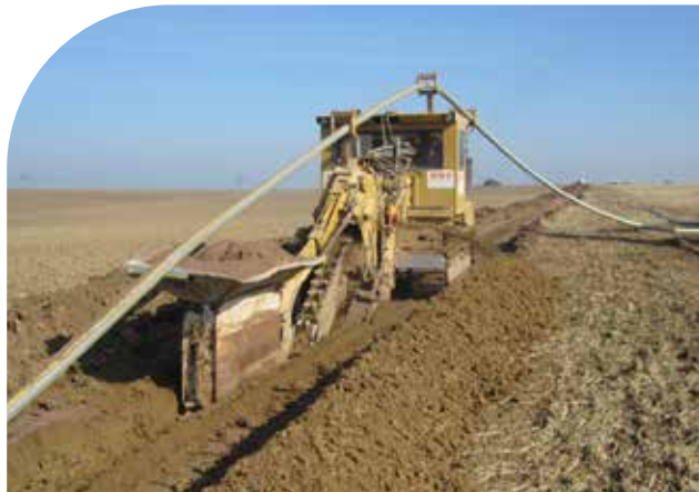
Bad Langensalza, toevoerleiding biogas, 16 bar
