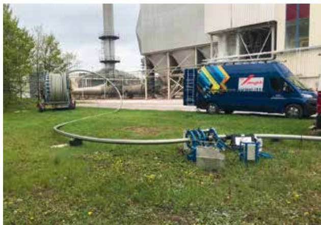
Nedmag Veendam, biogasleiding, 16 bar
